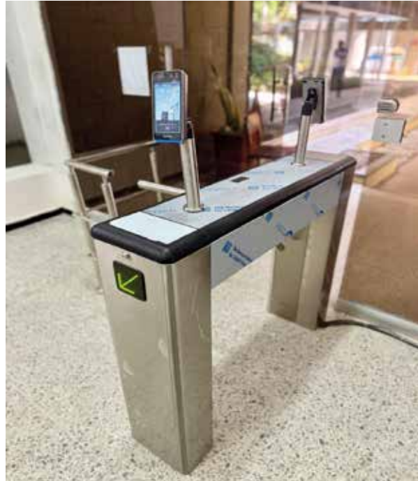
Ilustración 14. Control de acceso entrada bloque administrativo B
